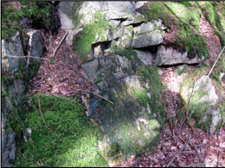
Abb. – Wasser dringt aus Naturfelsen am Kallenbruch.
